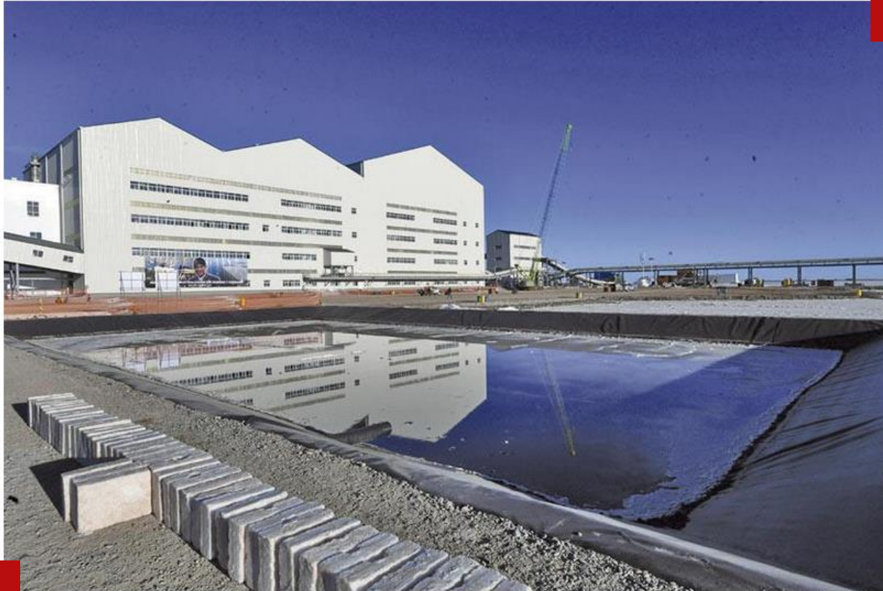
La planta de cloruro de potasio instalada en la región de Llipi Llipi.
