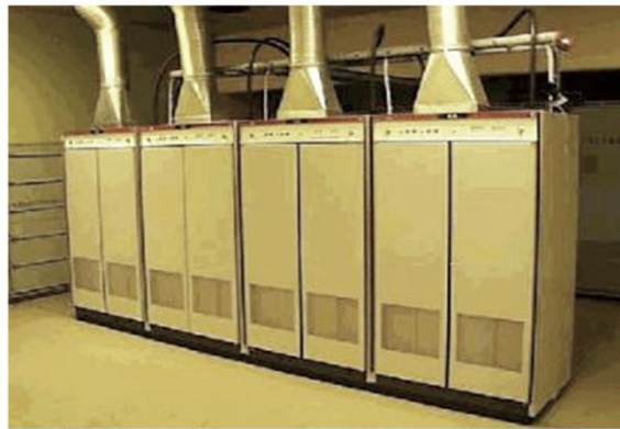
10 kW Collins effektsteg efter installationen 1988
