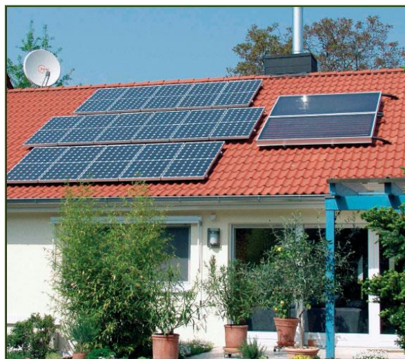
Рис.01-15 Система солнечного электро и горячего водоснабжения.
