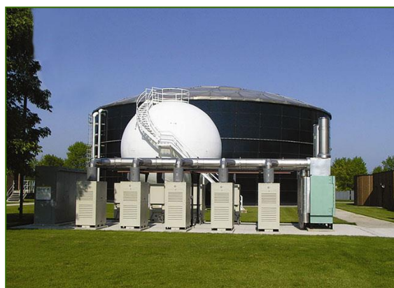
Рис. 01-13. Общий вид биогазовой установки
