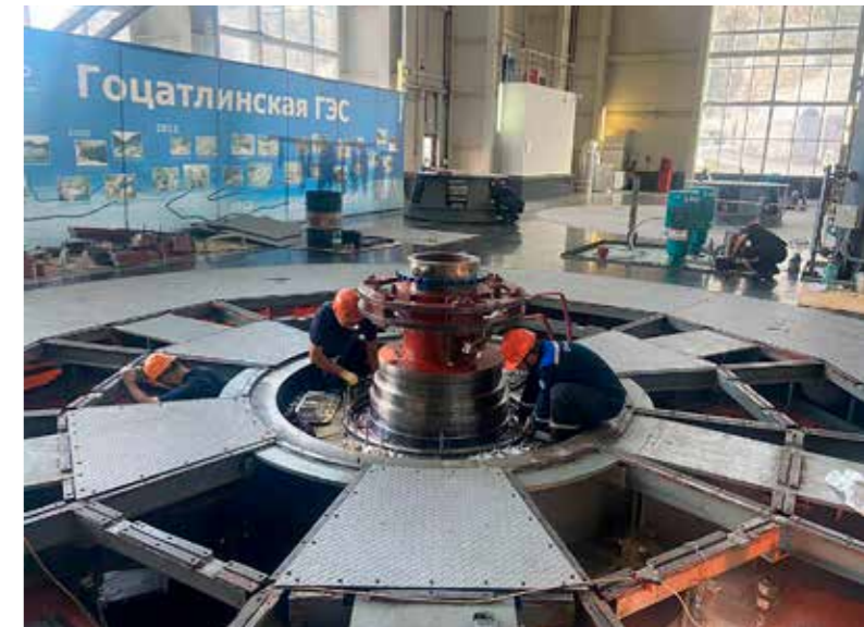
Гидроагрегат 1, Гоцатлинская ГЭС
