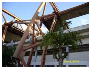
El Ateneo, un ejemplo del deterioro de las instalaciones deportivas.
